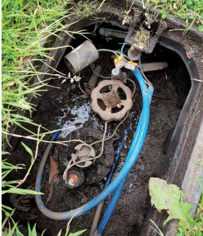
• Installation til fjernstyring af ventil i vandingsanlæg. Foto: Anders Kristoffersson.
