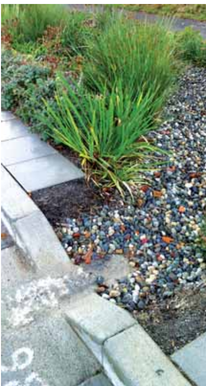
Vejbed med overløb til kloak.
