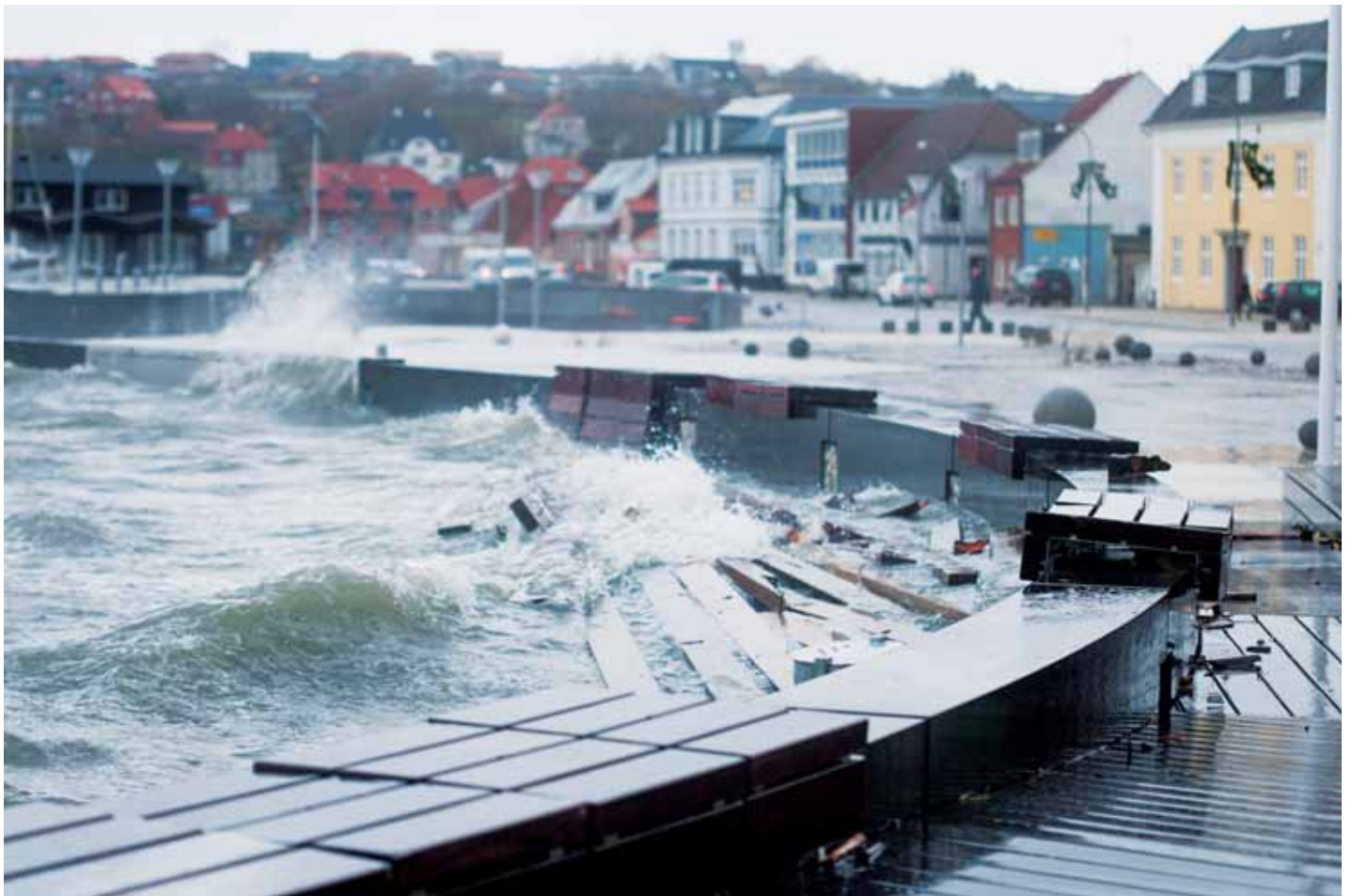
Højvandssikringen er i kote 2,1 meter, men på grund af bølgerne er det mere korrekt at sige at det kan håndtere vandstande på 1,9 meter. Enkelte ødelagte byrumsmøbler fra højvandssikringen skulper omkring i bølgerne. Foto: Mads Krabbe.
