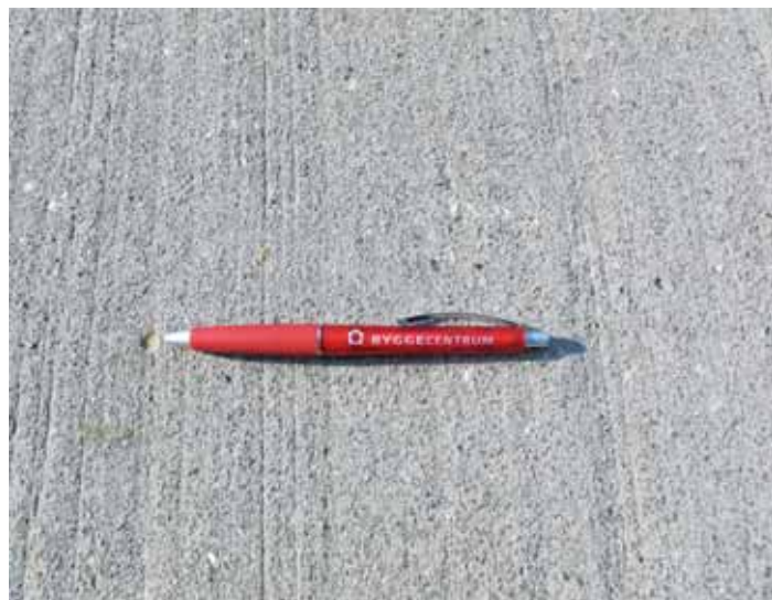
På de mest befærdede steder på CBS-stien er rillerne slidt næsten ned. Dermed mister man den friktion som kostningen skabte.
