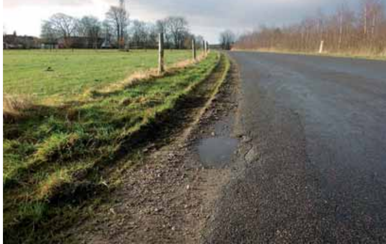
Vandafledningen fungerer ikke i de dybe hjulspor. Foto fra kogebogen.
