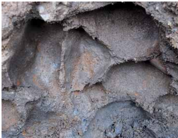
Aftryk efter sten i en forkert opbygget gartnermakadam med komprimeret vækstjord. Foto: Christian Nørgård Nielsen
