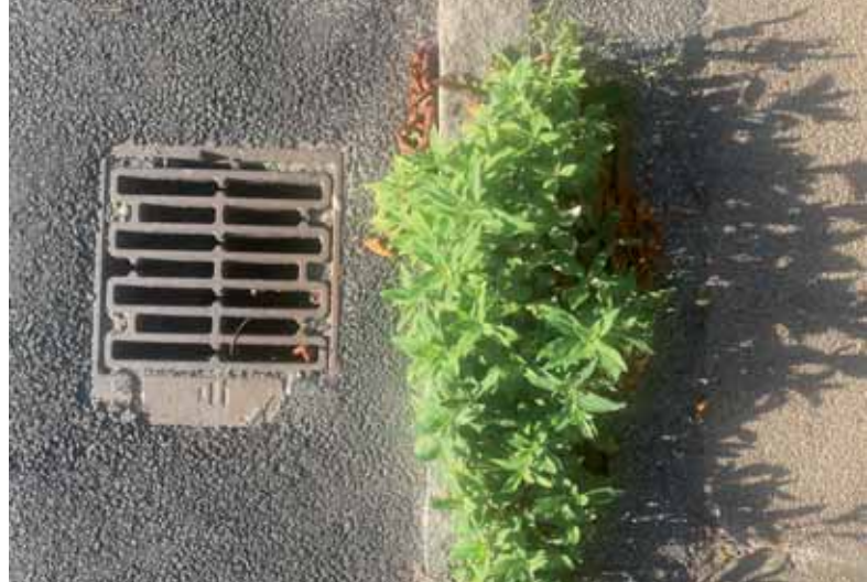
• Nedløbsbrønde leder regnvandet fra afløbssystemet og tilbageholder grus, sand, løv mv. i sandfanget. Men systemet virker ikke altid.
