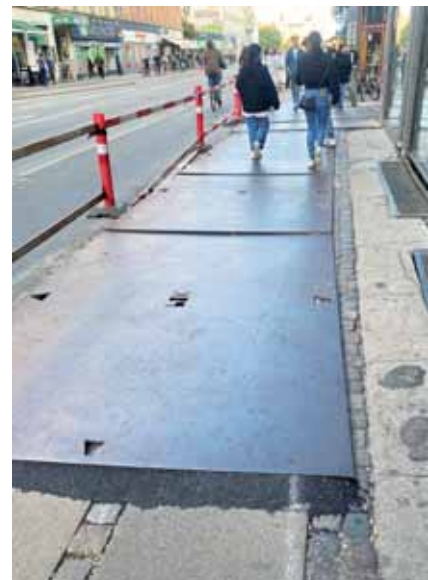
• Ved mindre og kortvarige anlægsarbejder anvendes ofte køreplader af jern. Opsping bør - som her - udlignes med asfalt.
