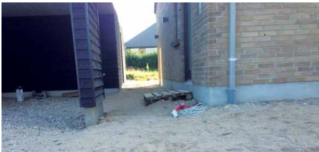
Garagen er opført i en al for lav kote. Hvordan opnår man nu både sokkelhøjde og niveaufri adgang?
