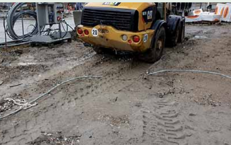
Tung kørsel på hovedkabel til byggestrømtavle. Foto: Sikkerhedsstyrelsen.
