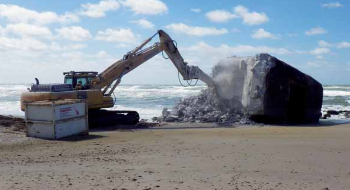
Bunkerne er eksponeret af erosion og forvitrer så farlige armeringsjern stikker ud. Foto: Kystdirektoratet.
