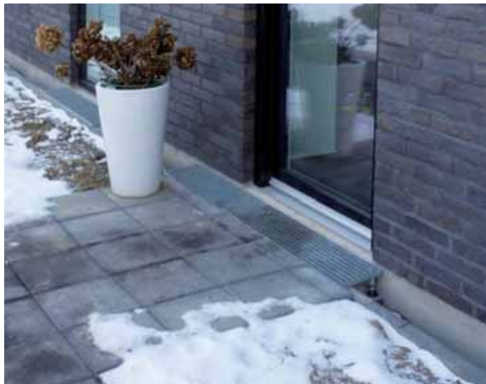
Nybyggeri med voldgravsløsning omkring rækkehus. Under et skybrud kan vandet kan stuve op ved facaden. Foto fra SBI-rapporten.
