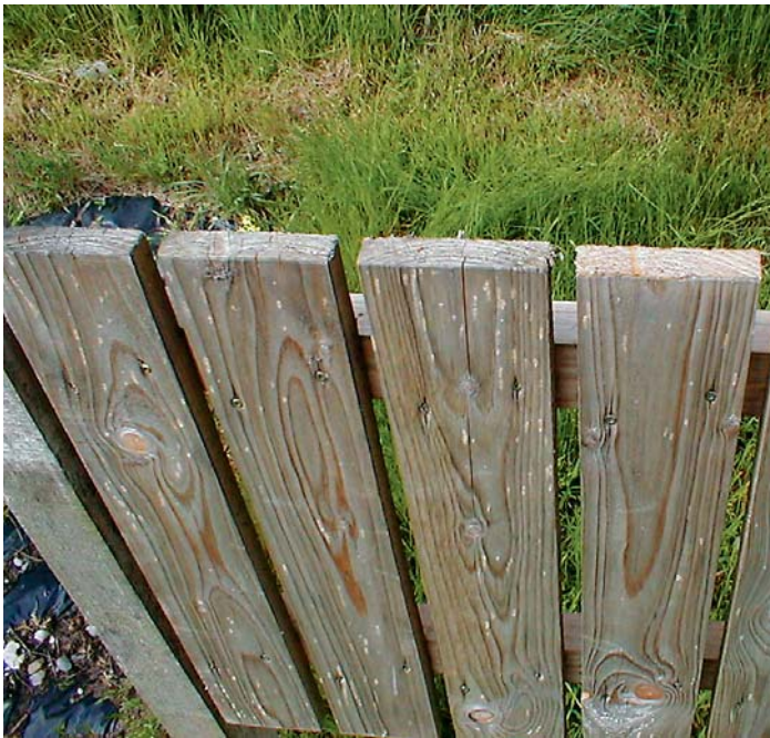
Stakit af gran, to år gammelt taget i tørt vejr. De tre brædder yderst til venstre er ikke endefladeforseglet. De øvrige brædder er. Bemærk den markant større tendens til dannelse af revner og ridser i de ubehandlede brædder. (Foto: CLaus Buhl Sørensen)
