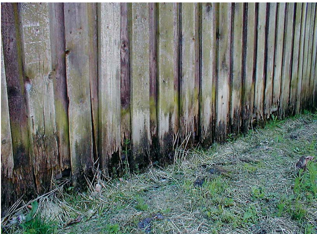
Gammel bræddebeklædning ført helt til jord. Brædderne opfugtes i bunden, og konstruktionen rådner fra bunden af. Reparation skal ske ved udskiftning af hele beklædningen. Alternativt kunne de nederste 30 - 50 cm, være udført med vandret beklædning der så løbende kunne udskiftes som del af husets almindelige drift. (Foto: Claus Buhl Sørensen)
