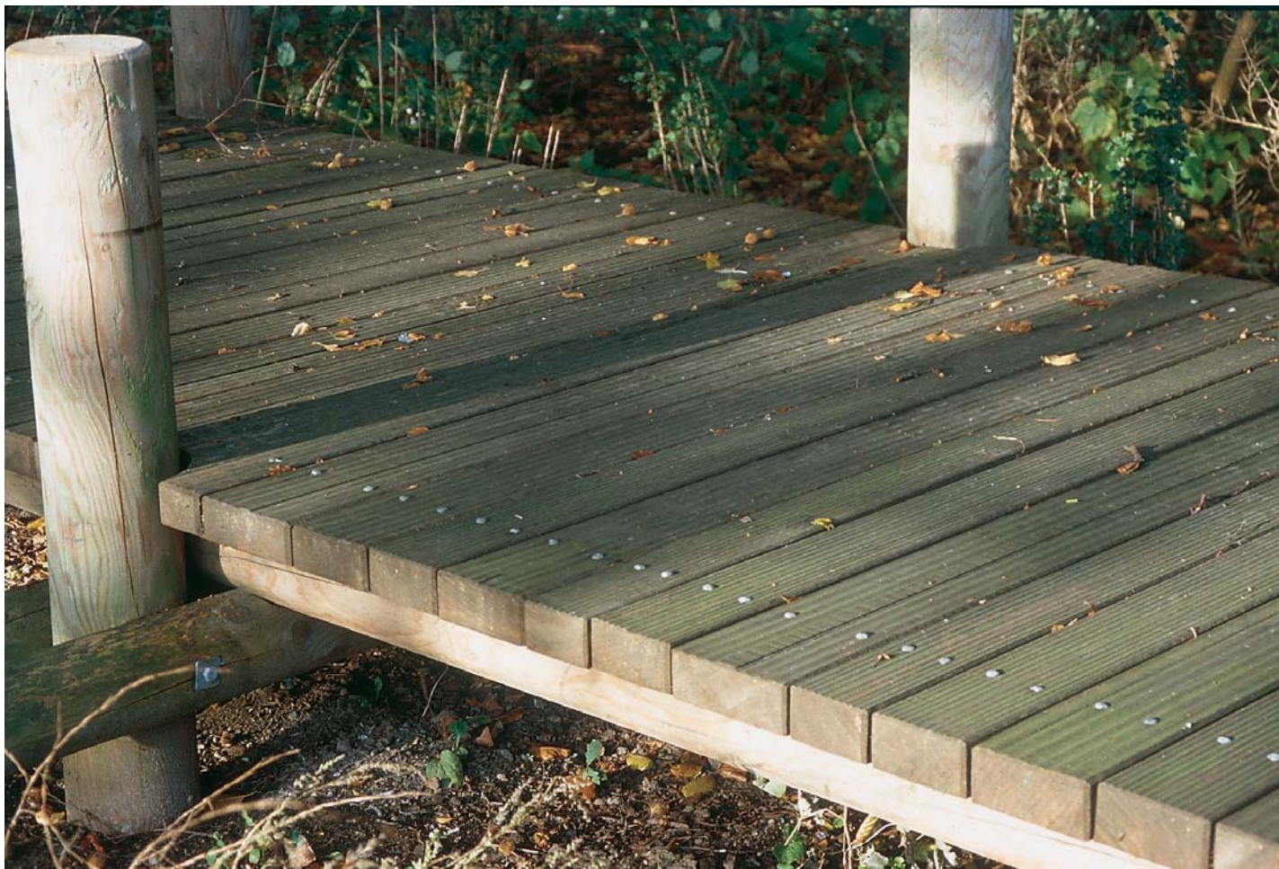
Gangbro i Valbyparken, København. Dækket er en ubehandlet elm, mens stolperne er en trykimprægneret fyr. Konstruktionen er et praktisk kompromis mellem miljøvenlig anvendelse af træ og hensyn til konstruktionens levetid. (Foto: Torben Dam)
