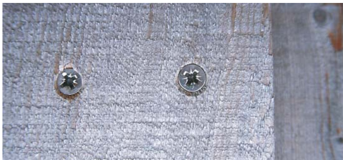
Thuja korroderer jern. De rustfrie skruer nederst angribes ikke. (Fotos: Torben Dam)
