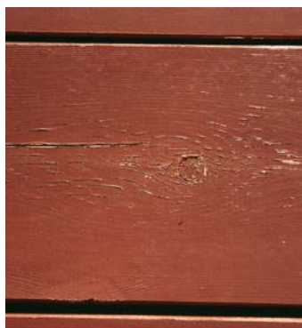
Den filmdannende maling er begyndt at sprække på billedet til venstre der er fra ydersiden af en port. Den er klar til et nyt lag maling. Indersiden af porten til højre har ikke været eksponeret for sol og regn og malingen dækker stadig. (Fotos: Torben Dam)
